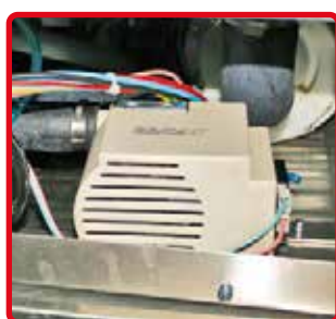
Bomba de descarga
