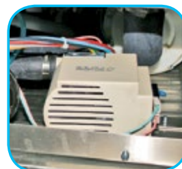
Bomba de descarga
