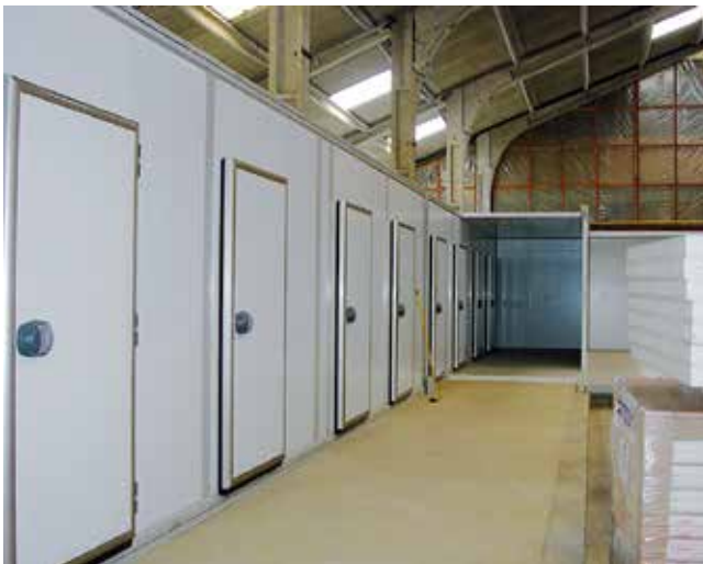
Multirecinto de cámaras adosadas Multiple adjacent cold rooms
