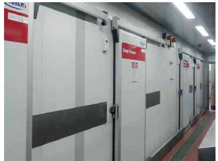
Multirecinto de cámaras adosadas Multiple adjacent cold rooms
